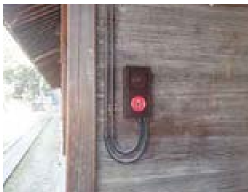
指定色を施し意匠に配慮した、総合盤（発信機・ベル・ランプ）
